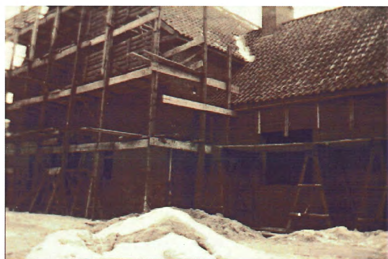
Das Dach ist drauf! (rechts die Wohnung, zunächst der Familie Andrich, später der Familie Lucklum)
